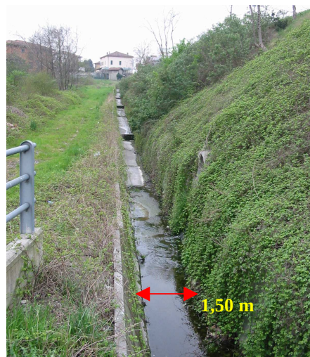
Alveo artificiale in fregio alla strada provinciale.
