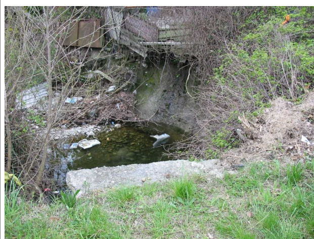
Fenomeni di erosione di sponda a valle di Via Boschetto.
